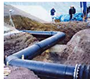
廃棄物処分場浸出水導水管
