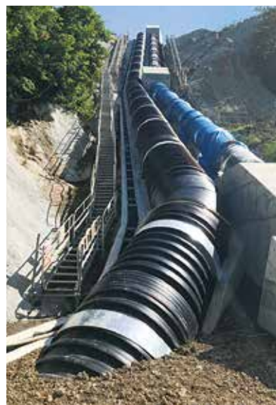
小水力発電水路
