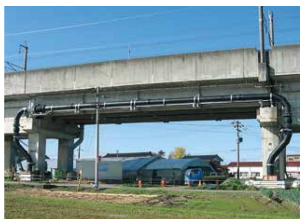
消雪用導水管路
