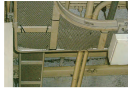
ケーブルラック 目隠し・ケーブル受け
